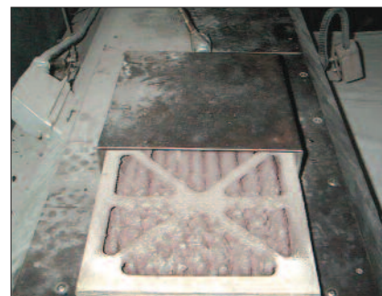
El polvo en la máquina se mete en los armarios eléctricos y obstruye los filtros. Si el filtro no está limpio, los componentes eléctricos se sobrecalentarán y se dañarán y pueden provocar un incendio. Foto: MEGTEC.
