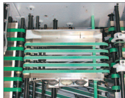
Inspeccionar periódicamente las correas por si hay desgaste, grietas y revisar la tensión correcta. Una tensión baja reduce el poder de transmisión y una tensión excesiva puede dañar los motores. Foto: Müller Martini.
